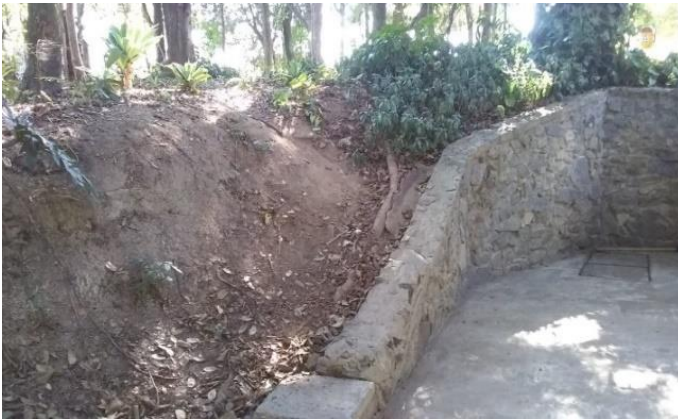
Figura 6: Area de talude sem plantio
